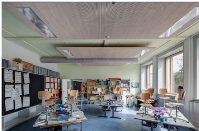
Klassenzimmer im Vischer-Bau des Schulhauses Hirzbrunnen mit abgehängten Akustikpaneelen zur Minderung der Nachhallzeiten. In die bestehenden Fensterrahmen wurden neue Wärmeschutzverglasungen eingebaut.
